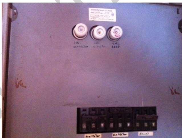
Obr. č. 4: vybavení rozvaděče
