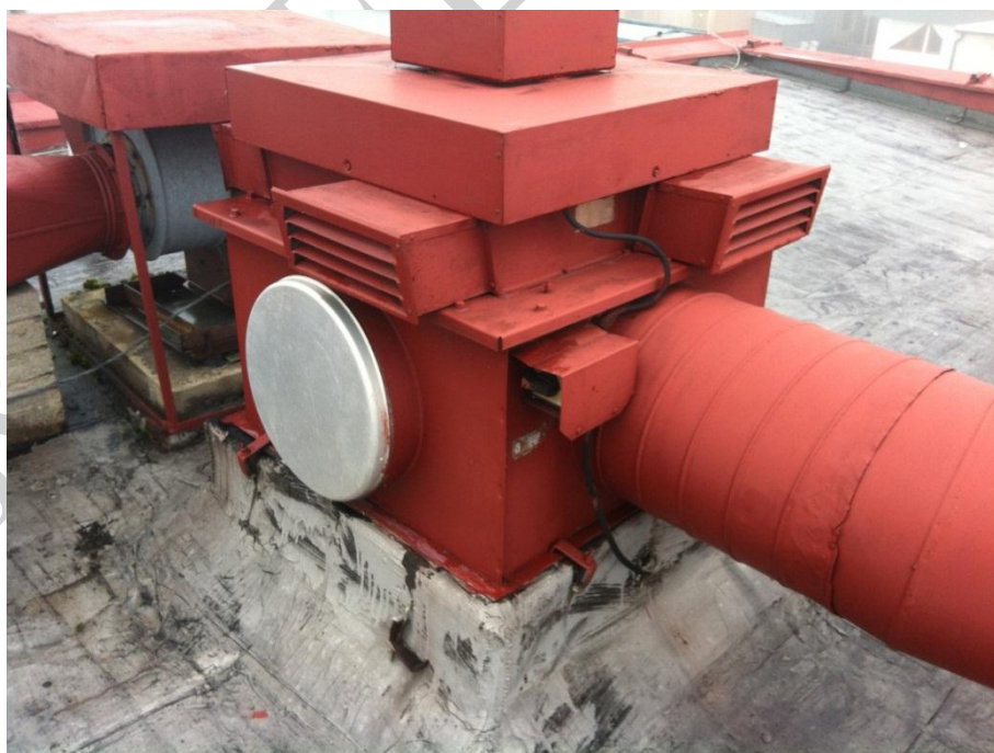
Obr. č. 1: Střešní jednotka centrálního odvětrávacího systému na střeše objektu.
